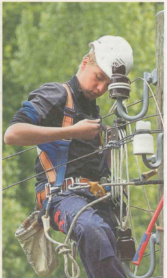
L'électricien de réseau a des tâches variées, mais il ne doit pas avoir le vertige. FÉLIX IMHOFF
